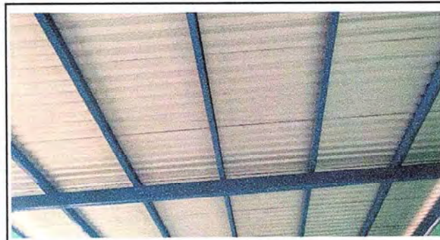
Se observa el cambio de las costaneras.
